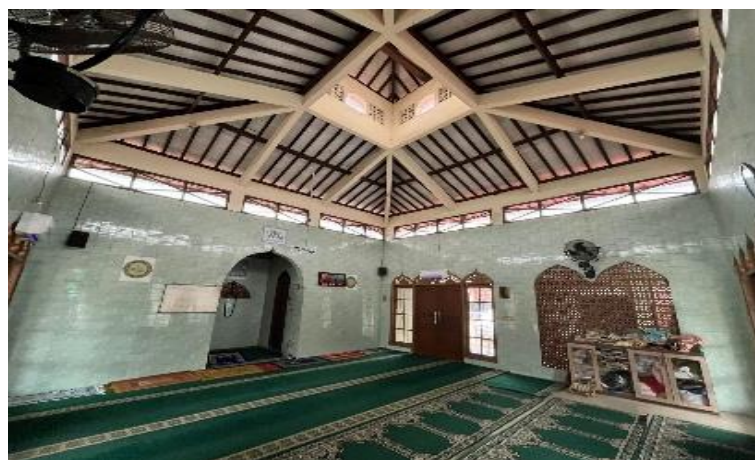
Gambar 1. Kondisi Instalasi dan Area Mushola Sebelum Perbaikan
