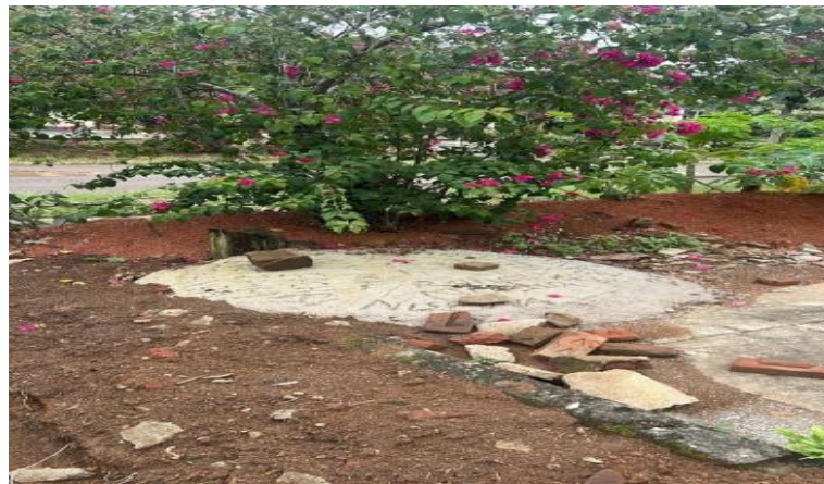
Gambar 11. Bangunan SPAL di Rumah Bapak Hasan Basri Kampung Pujo Kerto
