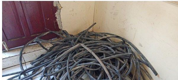
Gambar 5. Komponen kabel Cement Mill (Data perencanaan & evaluasi pemeliharaan, )
