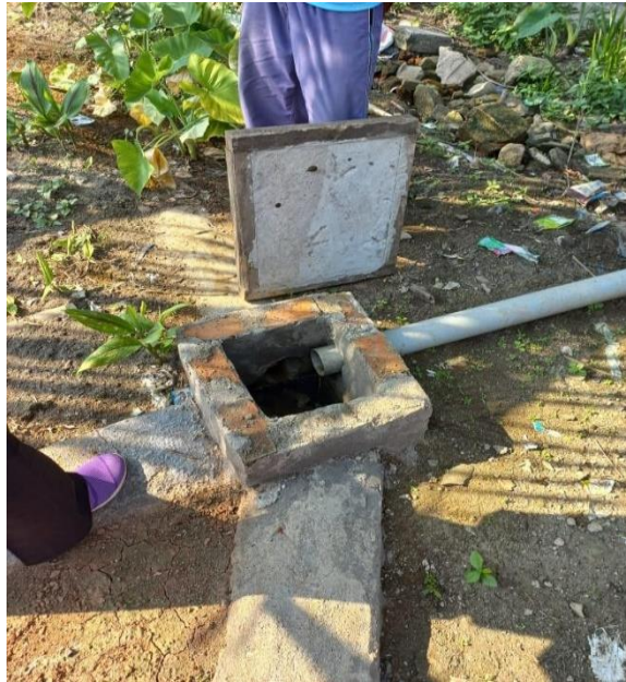
Gambar 11. Bak Kontrol Dari Kamar Mandi Menuju SPAL
