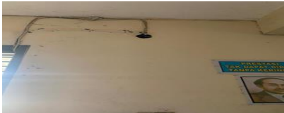
Gambar 4. Kondisi instalasi listrik di ruangan SMK Sasmita Jaya 2.
